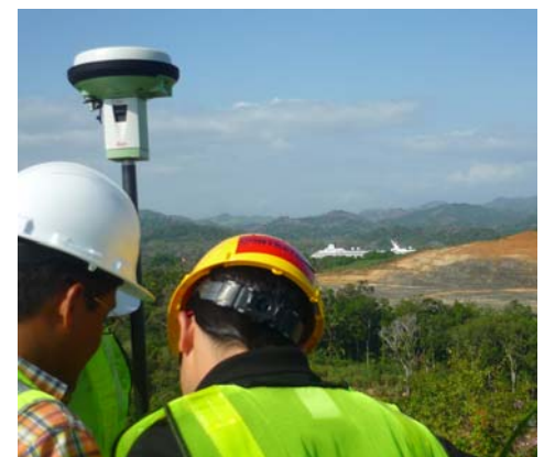
Tras 1.883 días que se prevén de intensísimo trabajo, al más alto nivel de exigencia técnica y humana, el proyecto debe estar concluido a finales de 2014, coincidiendo con el Centenario de la inauguración del Canal.
